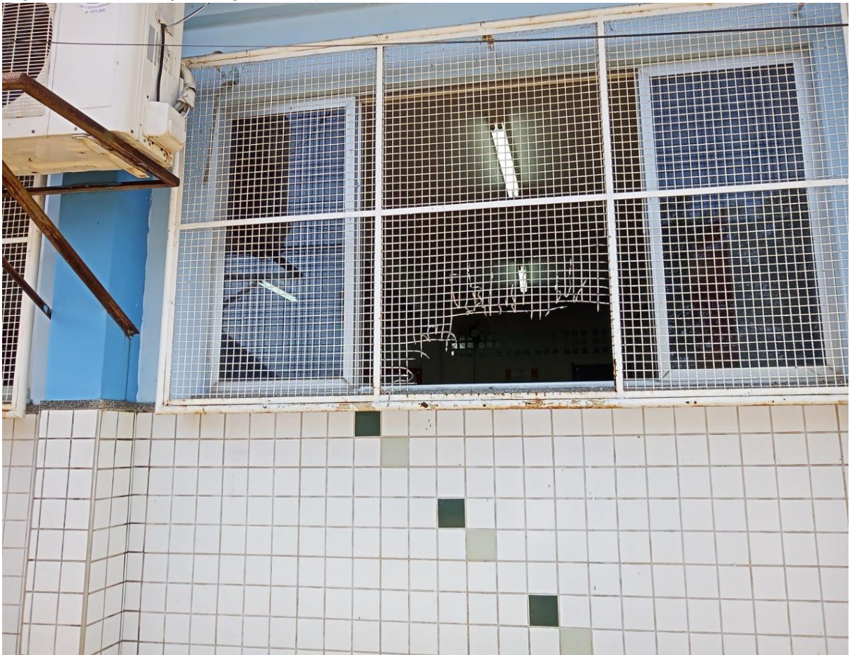
Figura 3: Depredação de grade da janela
