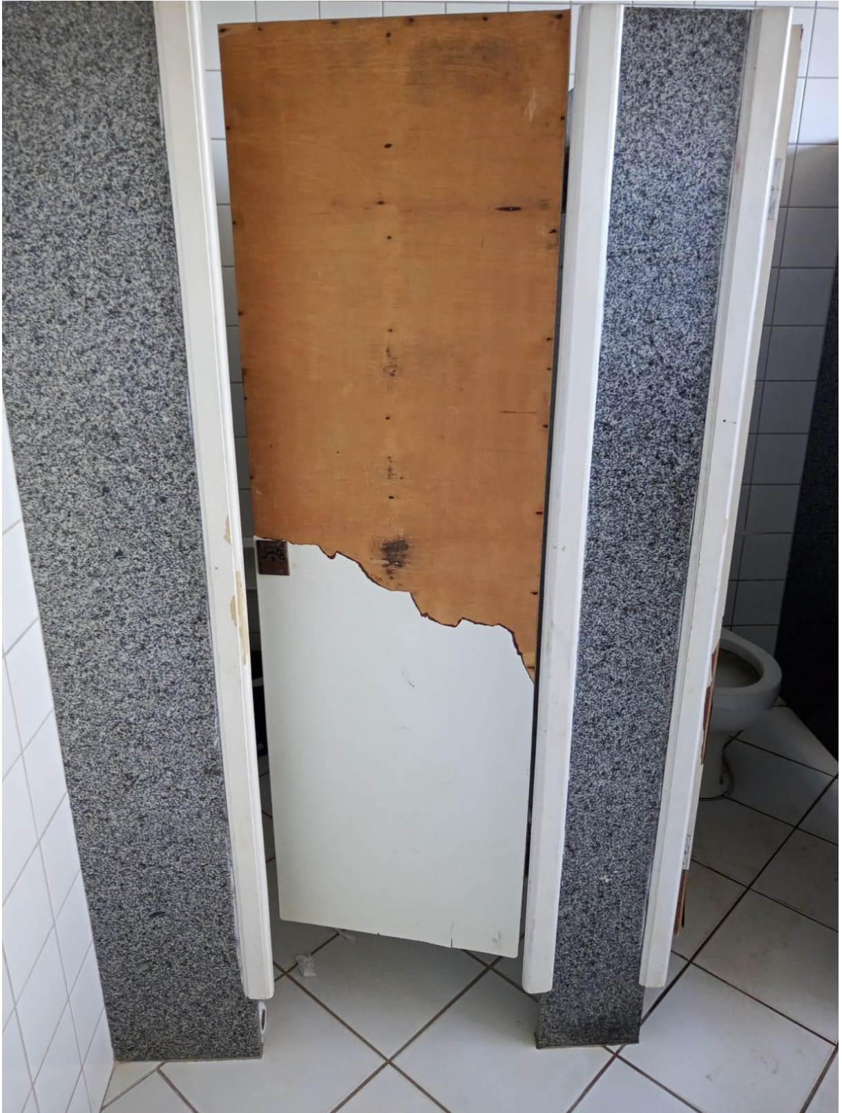
Figura 2: Depredação em porta de banheiro
