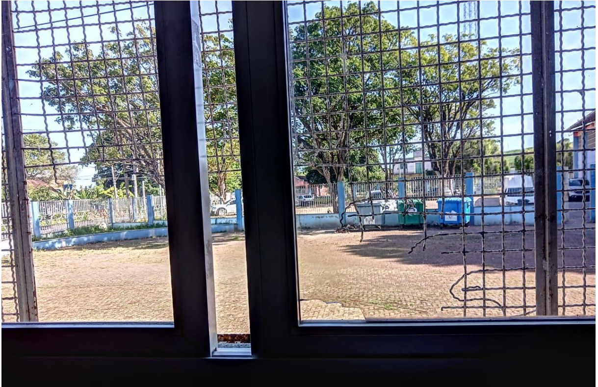
Figura 6: Depredação de janela
