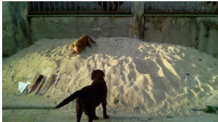
Figura 14 - Estocagem indevida de material
