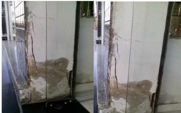
Figura 6 - Despendimento do concreto na base do pilar
