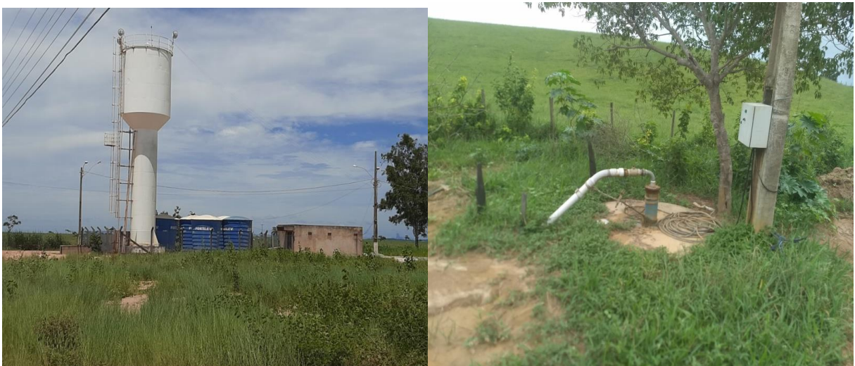
Figura 16 – Imagem do poço subterrâneo e reservatório utilizados para captar, armazenar e redistribuir água na comunidade de Santo Eduardo
