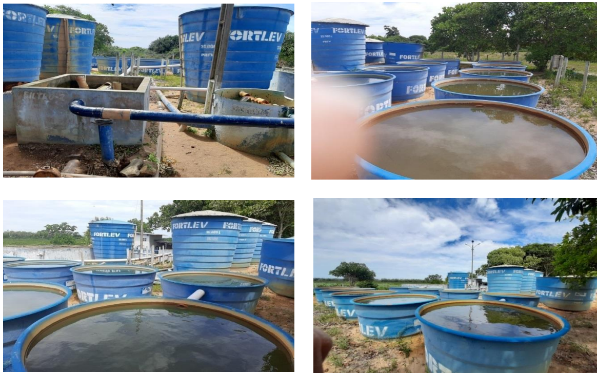
Figuras 20 – Imagens da estação de tratamento de água – ETA - na comunidade de Praia das Neves
