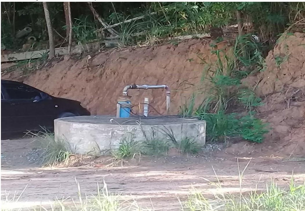
Figura 19 – Poço da SEMOB que abastece a comunidade de Mineirinho
