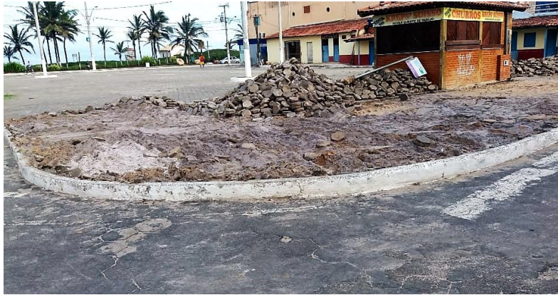
Figura 24: Praça no início da demolição no Centro de Guriri, São Mateus/ES. Fonte: arquivo pessoal. Julho 2019.
