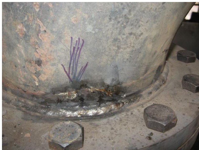
Figura 4 – Trinca em uma junta soldada
