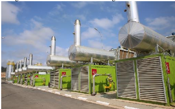
Figura 8: Termelétrica movida a biogás em Caieiras-SP
