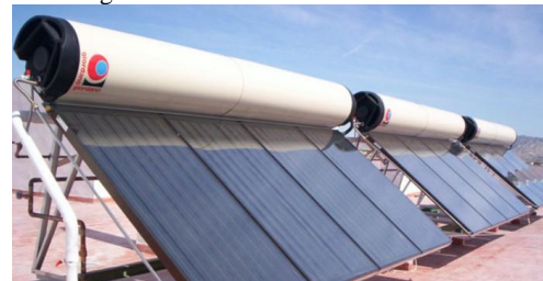
Figura 3 – Painéis solares térmicos
