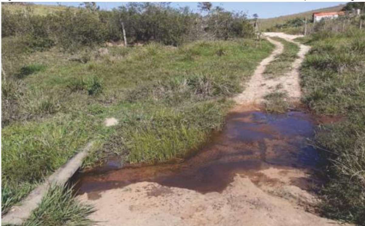
Figura 28 – Vista de uma estrada de acesso às moradias do Assentamento, cortada por um córrego
